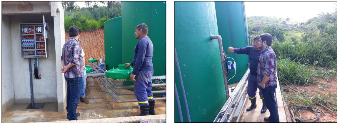
Figura 3.1 – Estação de Tratamento do Loteamento JC Oliveira.
