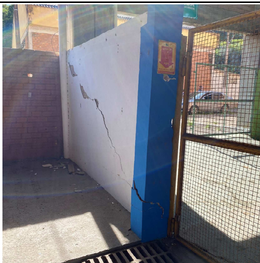
Foto 01 - Estande 11 Alvenaria em mal estado
