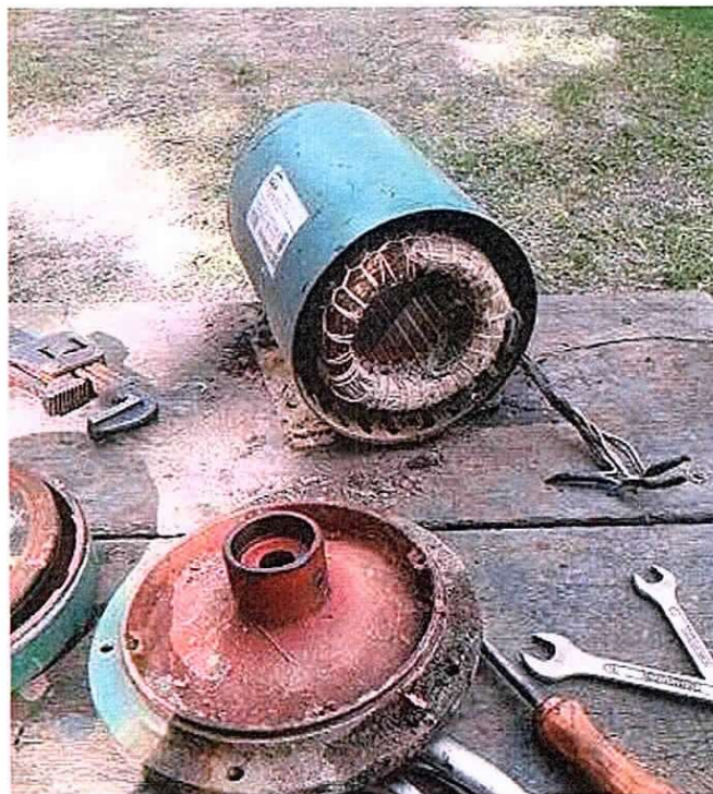
Figura 1: Bomba do filtro ETA Ibitiguaçu
