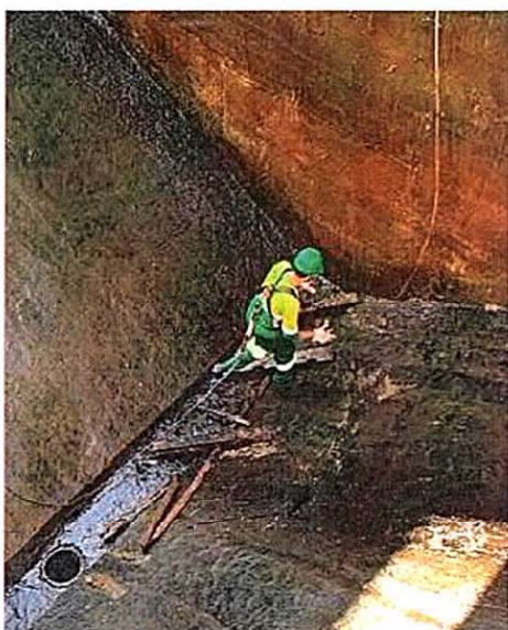
Figura 26: Decantador 1 ETA Principal
