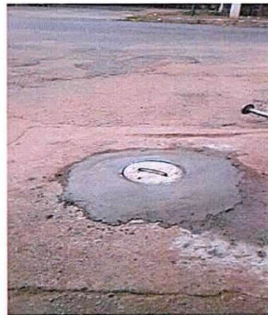
Figura 25: Tampa de proteção do registro
