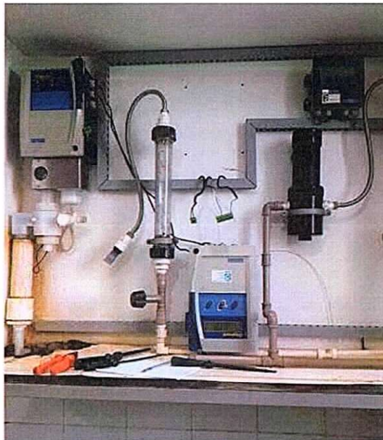
Figura 5: Monitor Coagulante ETA Principal
