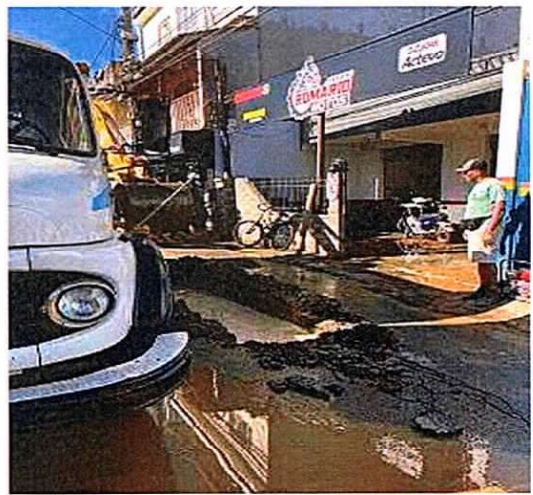
Figura 18: Rede PVC 110 DN rompida
