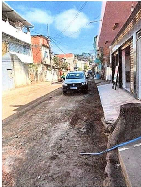
Figura 8: Reparo de ramal após rebaixo de via pública no bairro Cidade Nova
