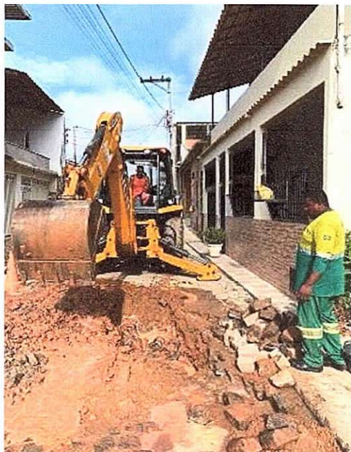
Figura 6: Vazamento de rede no Bairro Carvalhos
