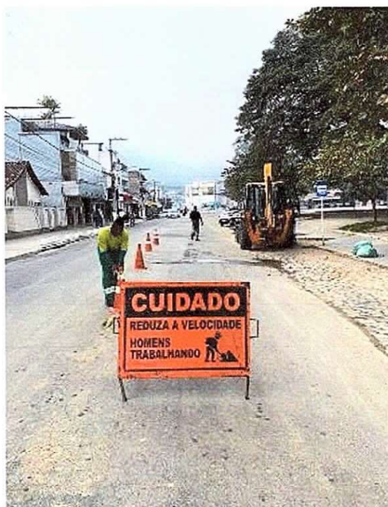
Figura 5: Vazamento de rede próximo à Praça Monsenhor Diniz
