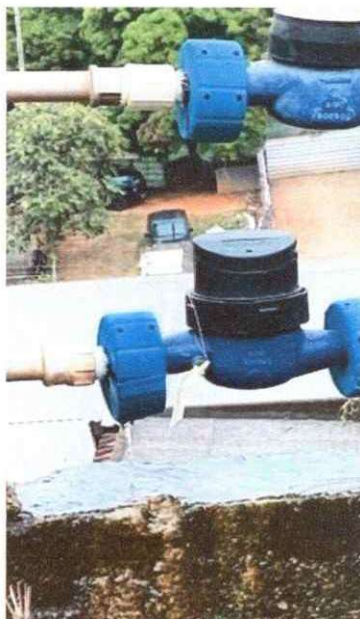
Figura 6: Vazamento de cavalete
