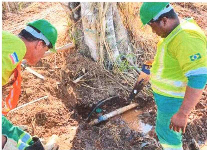
Figura 10: Vazamento interno do Parque Municipal
