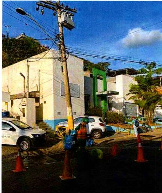
Figura 8: Vazamento de rede na R. Pref. Alberto Vaz
