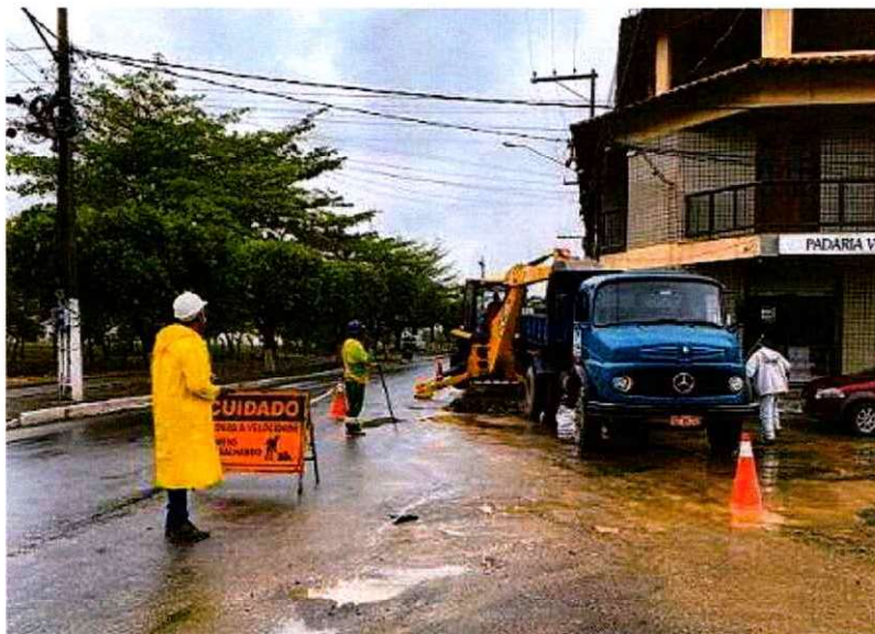
Figura 9: Vazamento de rede na Av. João Jasbick
