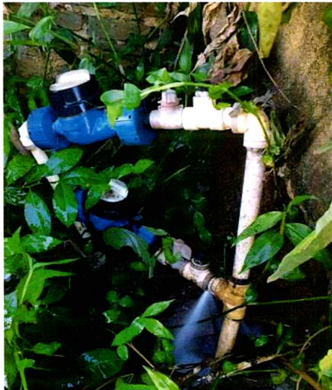
Figura 5: Vazamento de Cavalete
