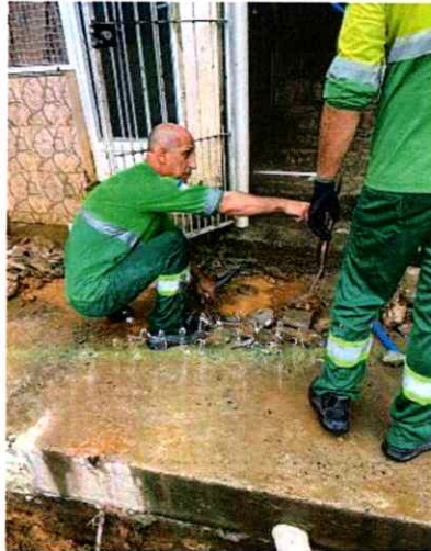
Figura 10: Ligação irregular de residência
