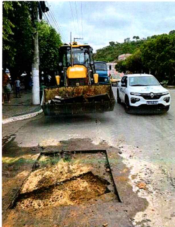
Figura 4: Vazamento de ramal próximo à Praça Visconde Figueira
