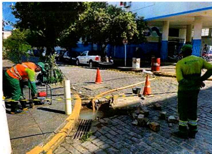
Figura 3: Vazamento de Rede no bairro Chácara
