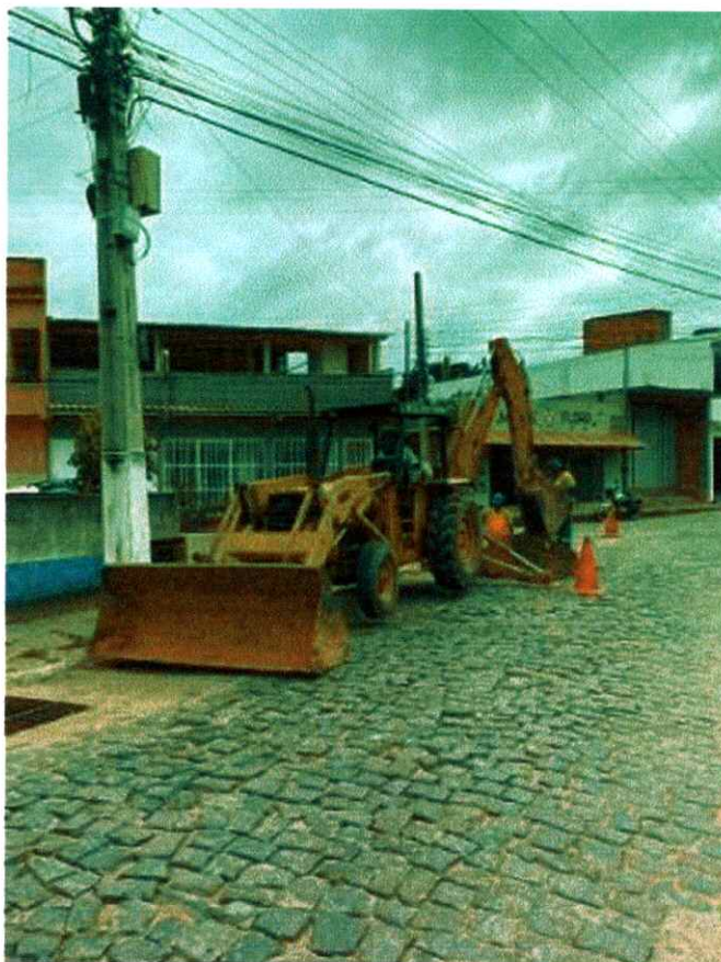
Figura 15: Retirada de registro com a gaveta caída
