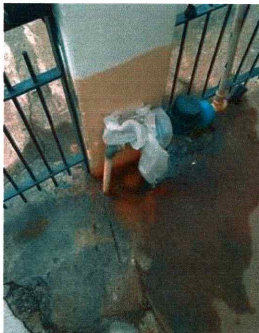
Figura 4: Vazamento de cavalete
