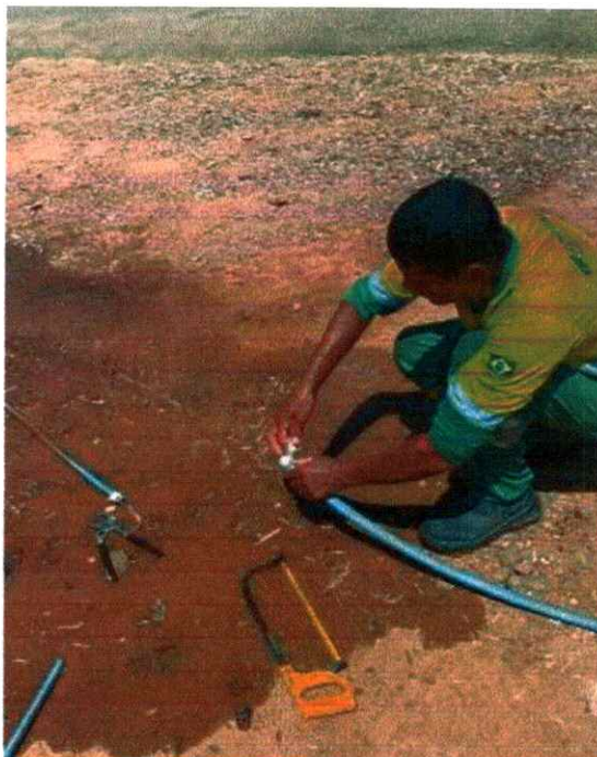
Figura 3: Reparo de vazamento de ramal
