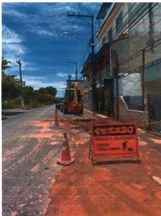
Figura 1: Vazamento de rede na Av. João Jasbick
