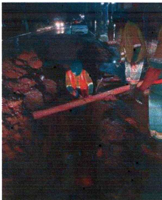
Figura 10: Vazamento de rede DN 110 PVC
