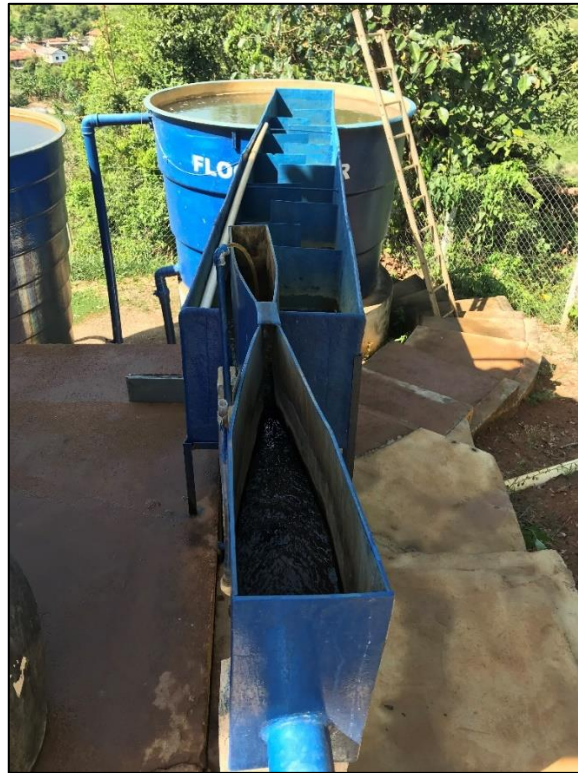
Figura 3.24 - SAA Santa Cruz - Calha Parshall.
