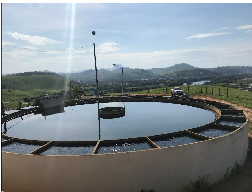
Figura 3.11 – Flocculadores e decantador.
