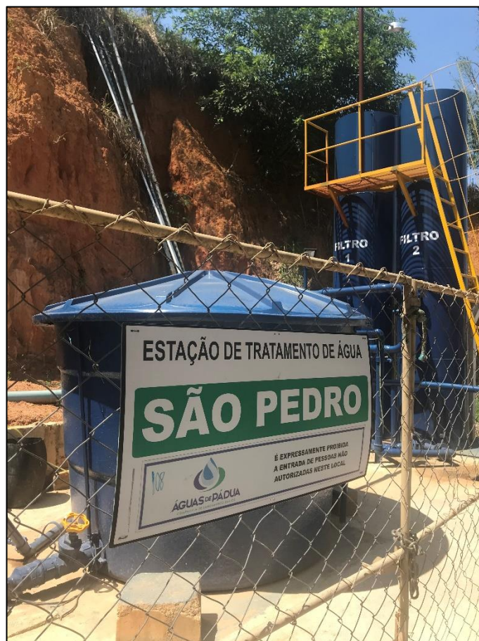
Figura 3.32 – SAA São Pedro de Alcântara – Estação de tratamento de água.
