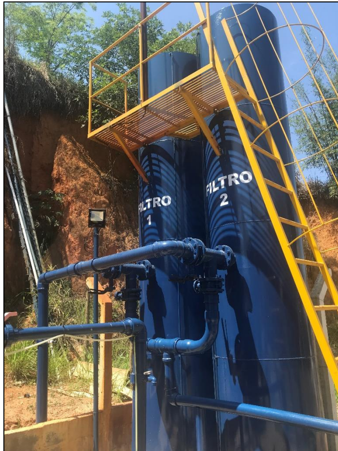
Figura 3.33 - SAA São Pedro de Alcântara – ETA, Filtros.
