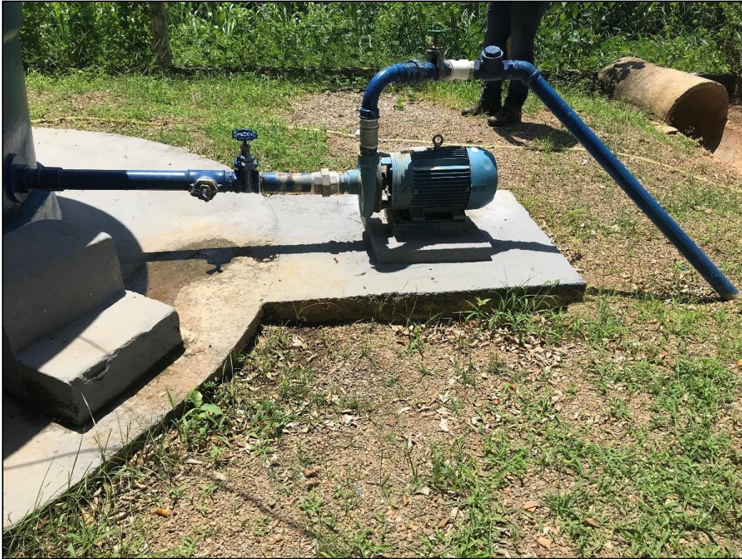
Figura 3.51 - SAA Monte Alegre - Poço de captação.
