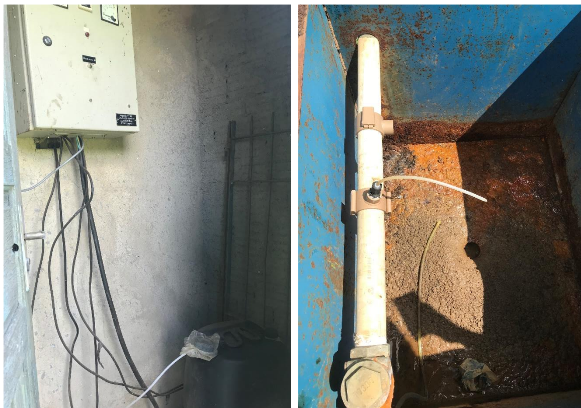
Figura 3.55 – SAA Bom Jardim - equipamentos.
