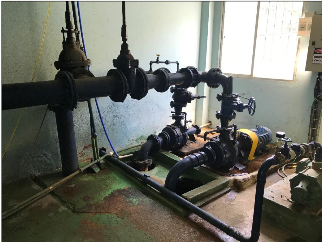
Figura 3.16 – SAA Campo-Paraoquena – Recalque de água tratada.
