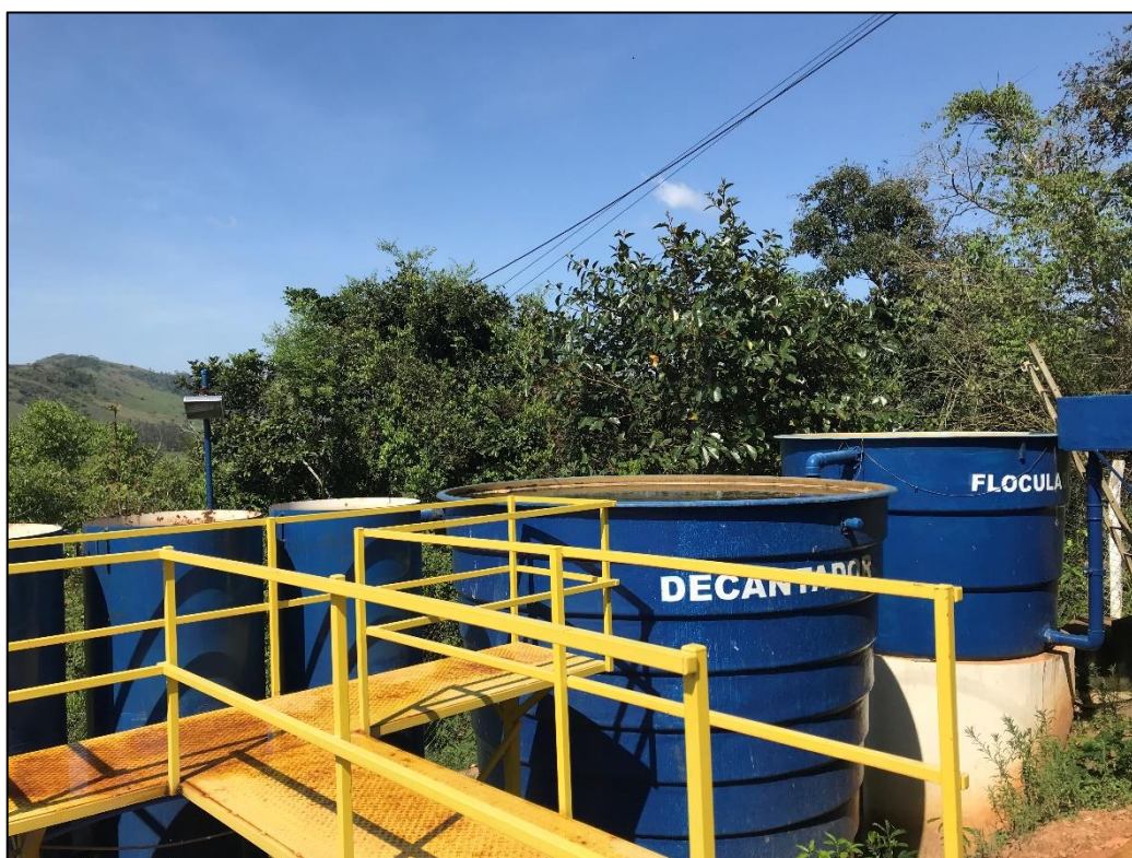
Figura 3.23 - SAA Santa Cruz - Estação de tratamento de água.
