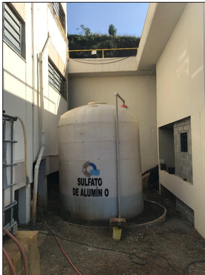
Figura 3.3 – Reservatório de sulfato de alumínio.
