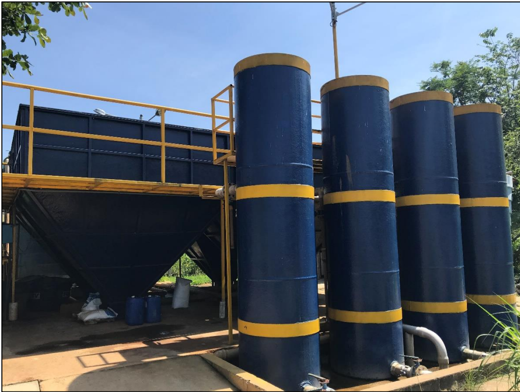
Figura 3.29 - SAA Ibitinema – Estação de tratamento de água.
