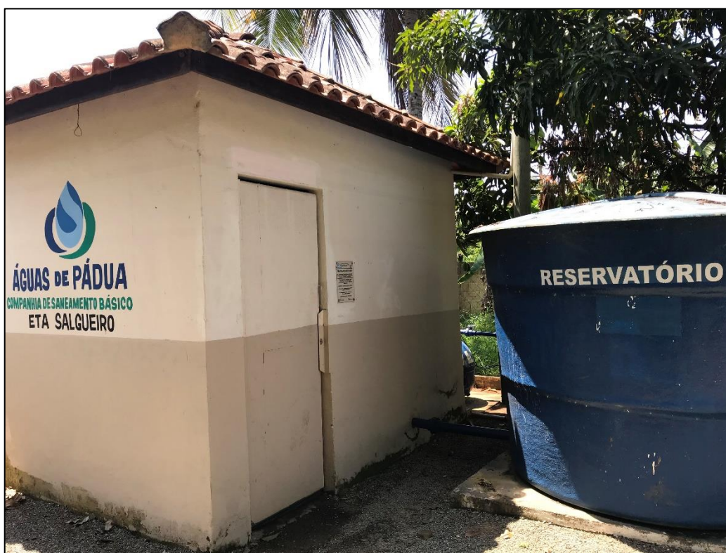
Figura 3.43 - SAA Salgueiro - Estação de tratamento de água.
