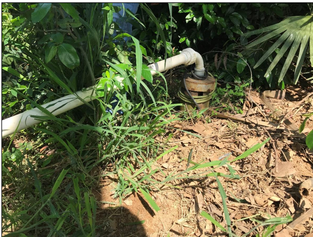
Figura 3.22 – SAA Santa Cruz – Captação subterrânea, poço tubular.
