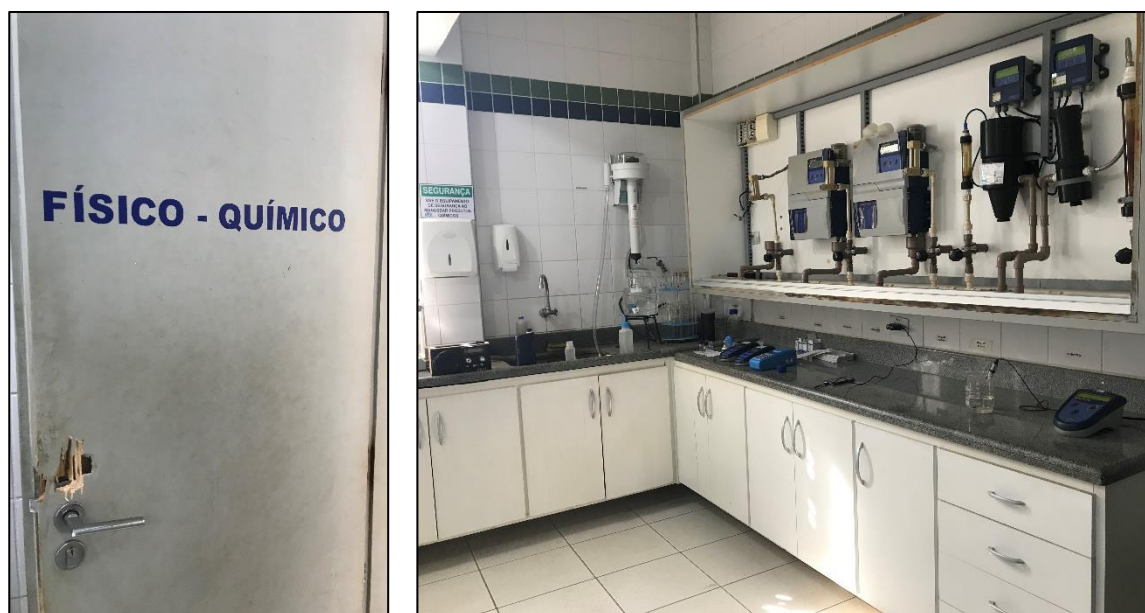
Figura 3.8 - SAA Principal - Laboratório físico-químico.
