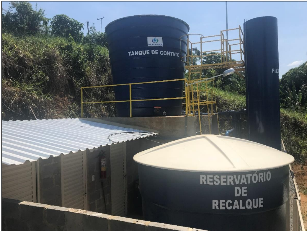
Figura 3.37 – SAA Boa Nova – Estação de Tratamento de Água.
