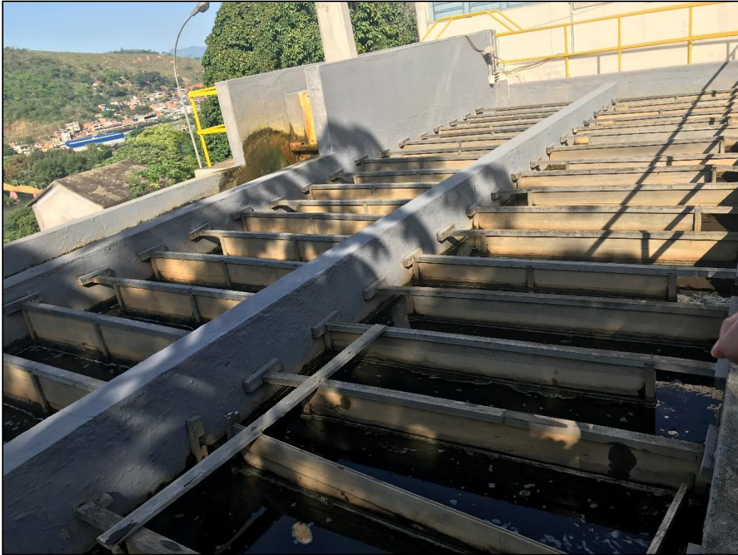
Figura 3.5 – SAA Principal - Flocculador Hidráulico.
