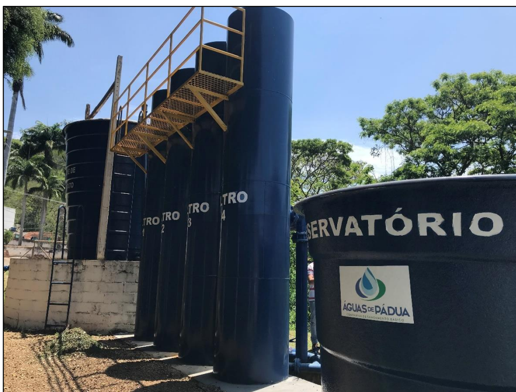
Figura 3.50 - SAA Monte Alegre - Estação de tratamento de água.
