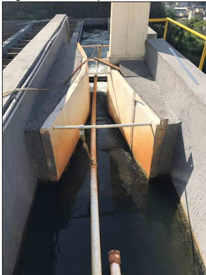
Figura 3.6 – SAA Principal - Calha parshall.
