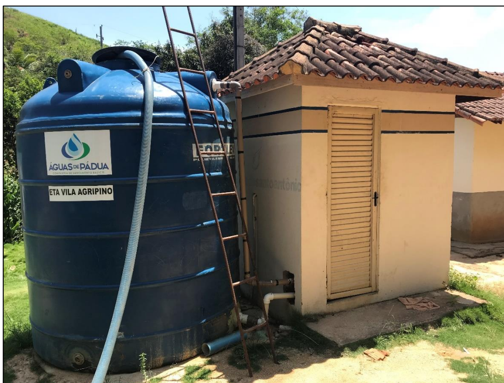
Figura 3.52 - SAA Vila Agripino – Estação de tratamento de água.
